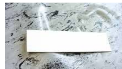
Рис. 11. Образование пузырей при несоблюдении требований по укладке
